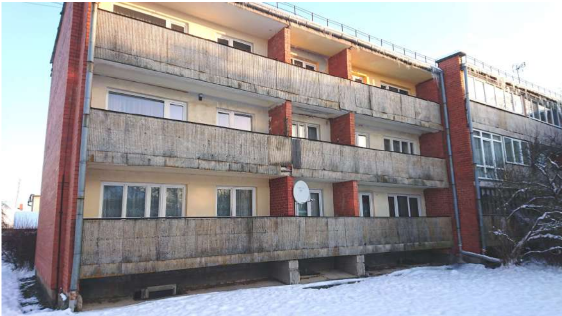
6.att. Lodžiju margas un apdares plātnes ir nolietojušās; lodžijas nav paredzēts iestiklot; esošās margas tiks remontētas.
