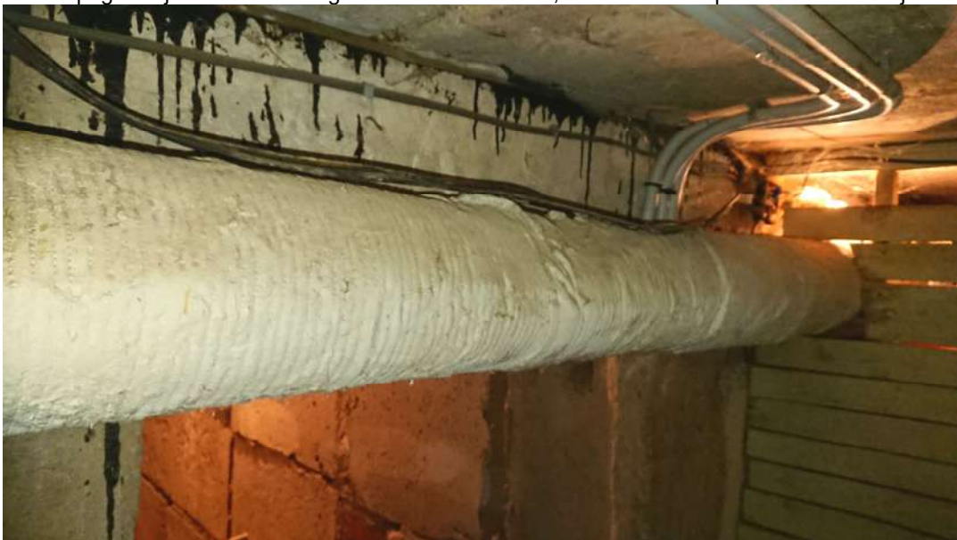
13.att. Pagrabā esošie inženiertīkli jāatvirza no griestiem līdz pagraba pārseguma siltināšanai.
