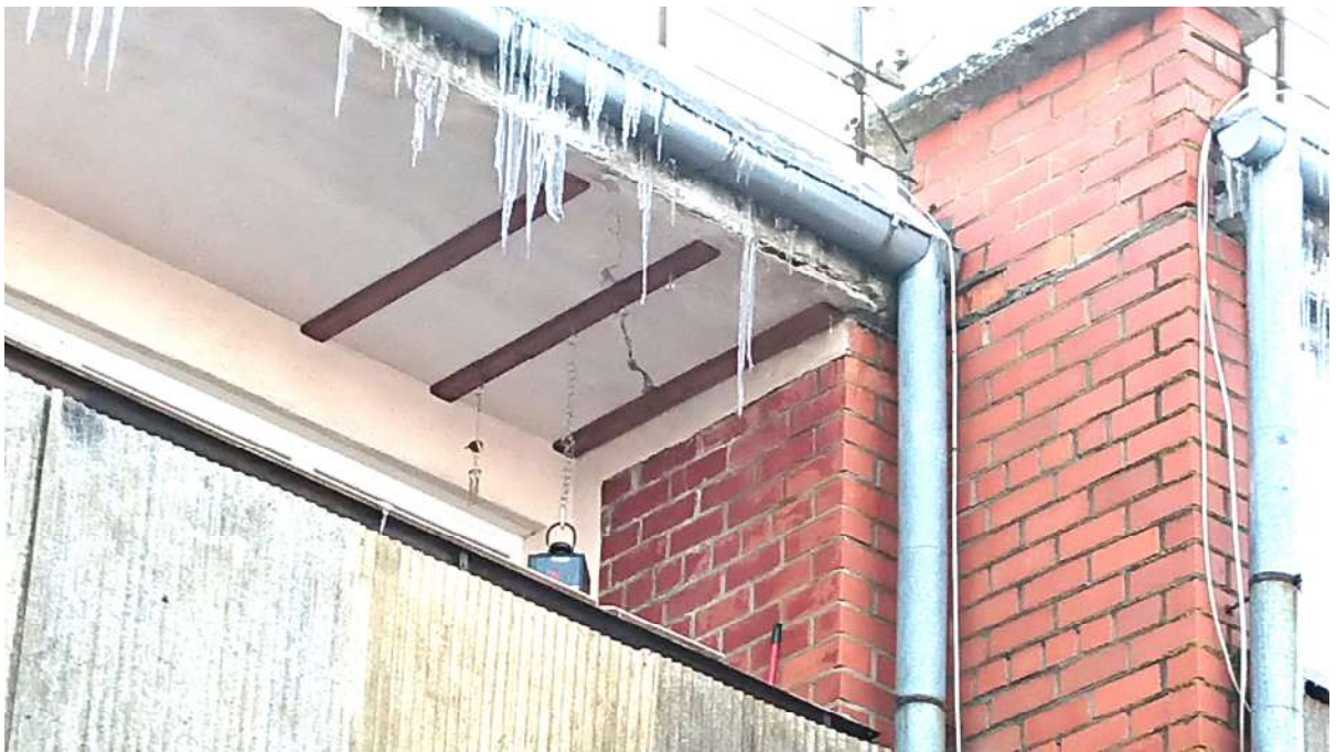
9.att. Vairākiem lodžiju pārsguma paneliem bojāta apakšējā betona aizsargkārtas;dažiem ir plaisas, kas jāremontē.
