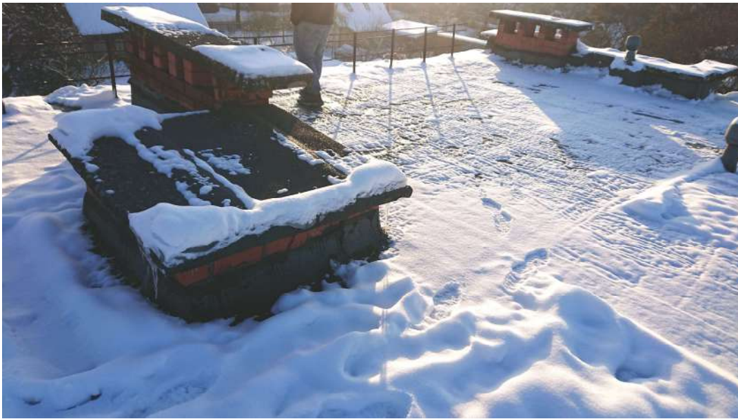
16.att. Jumta segums pirms dažiem gadiem atjaunots; papildus nav siltināts. Mūra ventilācijas izvadi mitruma bojāti.
