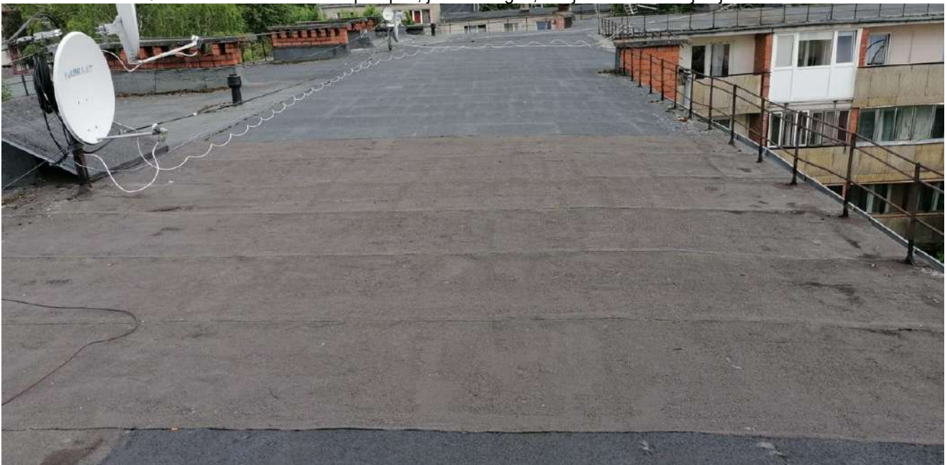
23.att. Citā laika periodā uzņemts jumta foto: redzams atjaunots segums, jumta margas,ventlācijas izvadi. 25.att. Plaisas mūra pilastros, kas ir jāremontē
