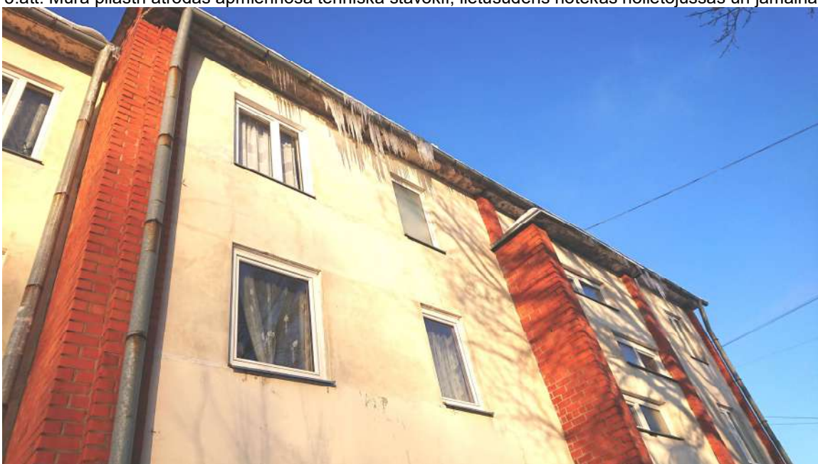
4.att. Mūra pilastrī atrodas apmierinošā tehniskā stāvoklī; teknes un notekas jāmaina, jumts jāsiltina.
